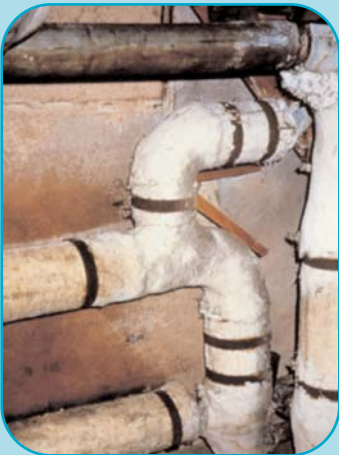
Asbestos pipe lagging
